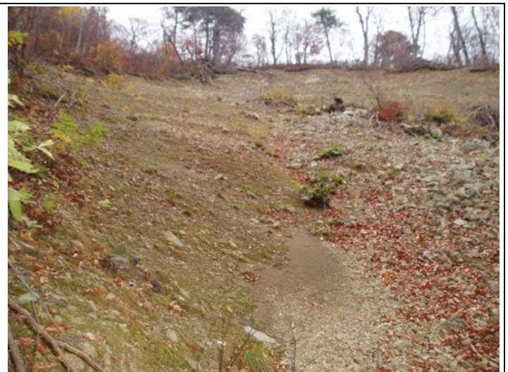
東日本大震災で崩落した現場（北ノ俣沢）
